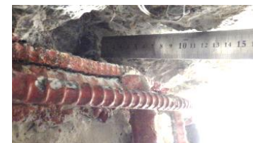
No.8杭主筋の破断状況
