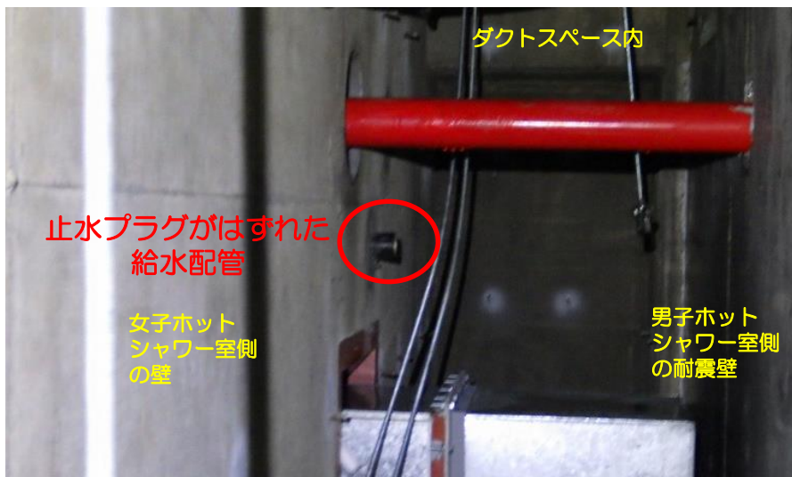
[漏水箇所写真]
