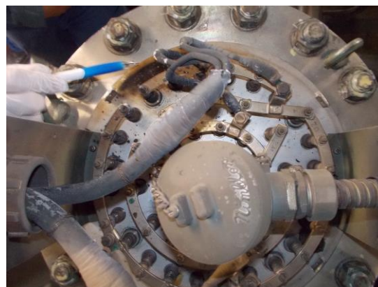
電気ヒータの焼損部（除湿装置上面）
