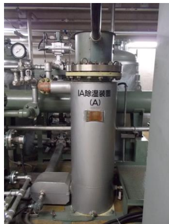
計装用圧縮空気系除湿装置 電気ヒータ
