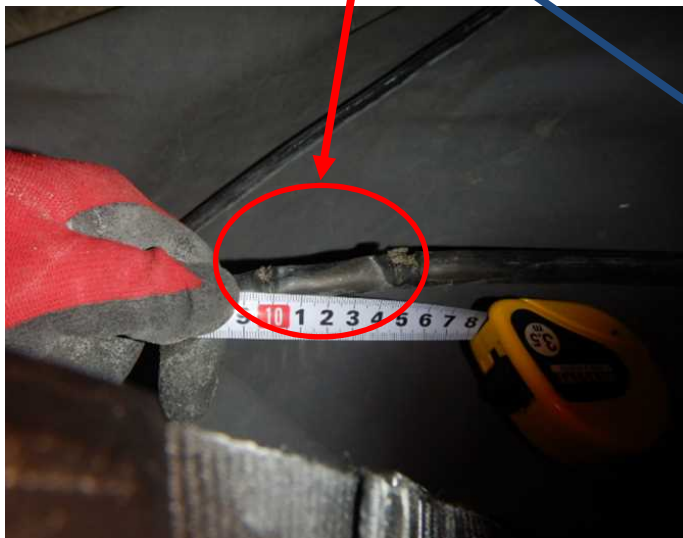
ケーブル損傷の状況
