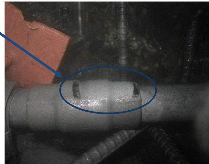
電線管損傷の状況
