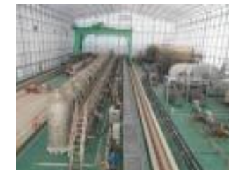
(高性能多核種除去設備)
