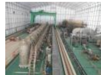
(高性能多核種除去設備)
