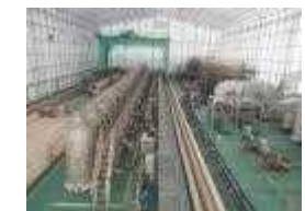
(高性能多核種除去設備)
