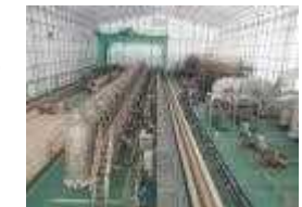
(高性能多核種除去設備)
