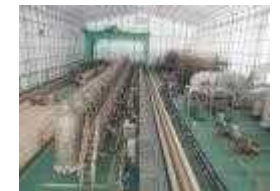
(高性能多核種除去設備)
