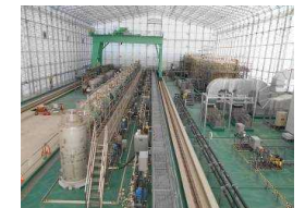
(高性能多核種除去設備)
