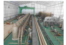
(高性能多核種除去設備)
