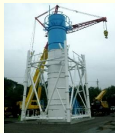
排気筒模擬施設
