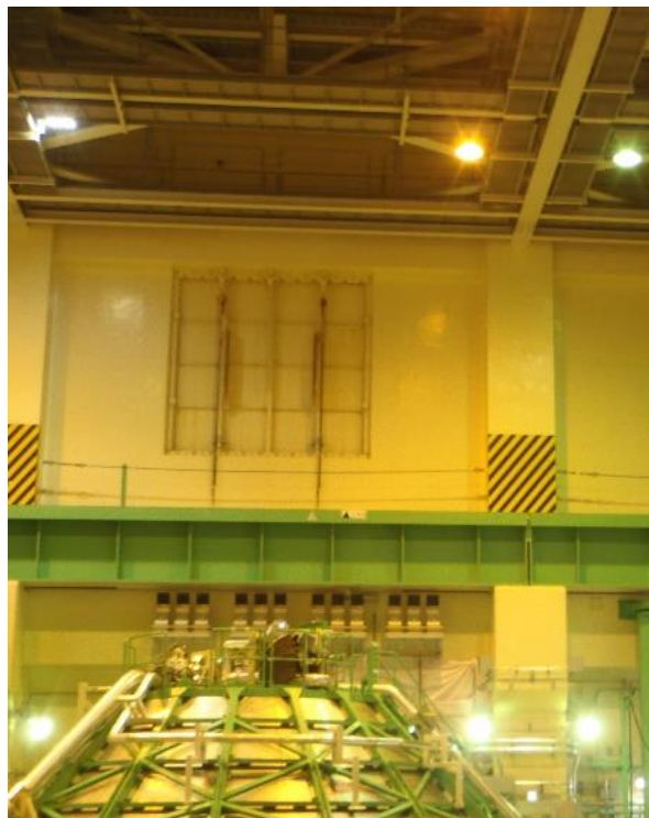
7号機原子炉建屋 ブローアウトパネル
