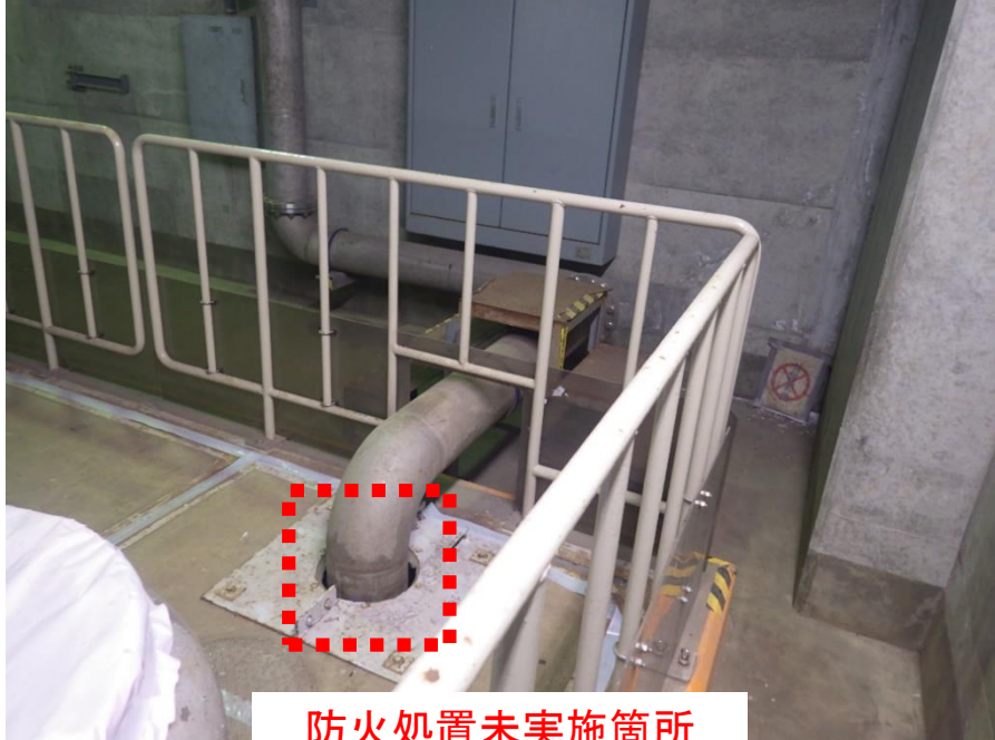
防火処置未実施箇所
