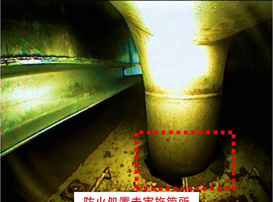
防火処置未実施箇所
