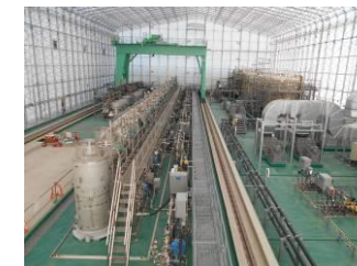
(高性能多核種除去設備)
