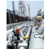
(凍結管バルブ 開閉操作の様子)
