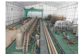
(高性能多核種除去設備)
