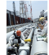
(凍結管バルブ開閉操作の様子)
