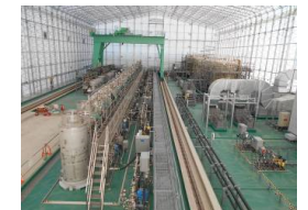
(高性能多核種除去設備)
