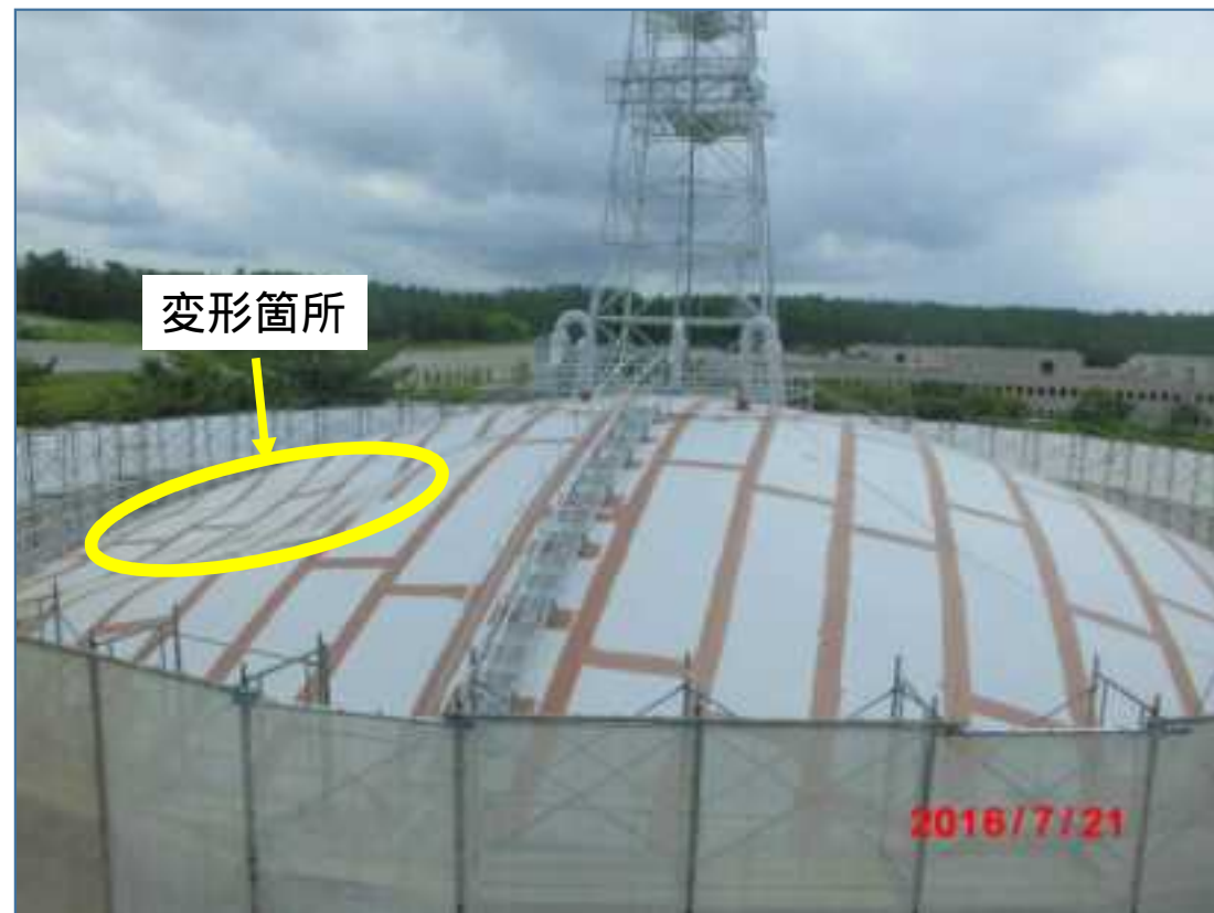
ろ過水タンク変形箇所
