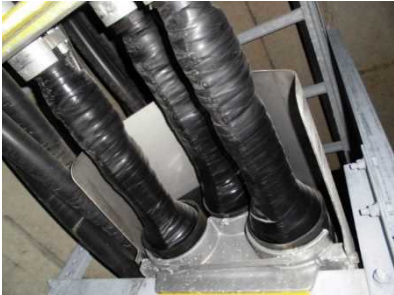
<66kV GIS～LSTr6SB間の接続部>
