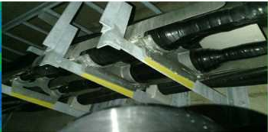
<66kV GIS～LSTr6SB間の接続部>
