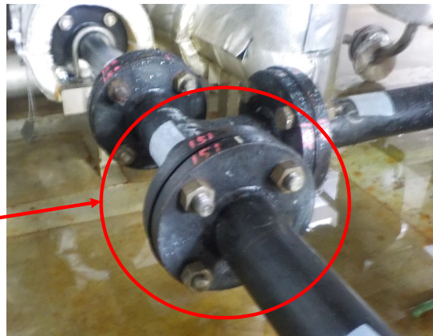
電解鉄イオン供給装置近傍にある配管接続部 漏えい箇所(配管接続部)
