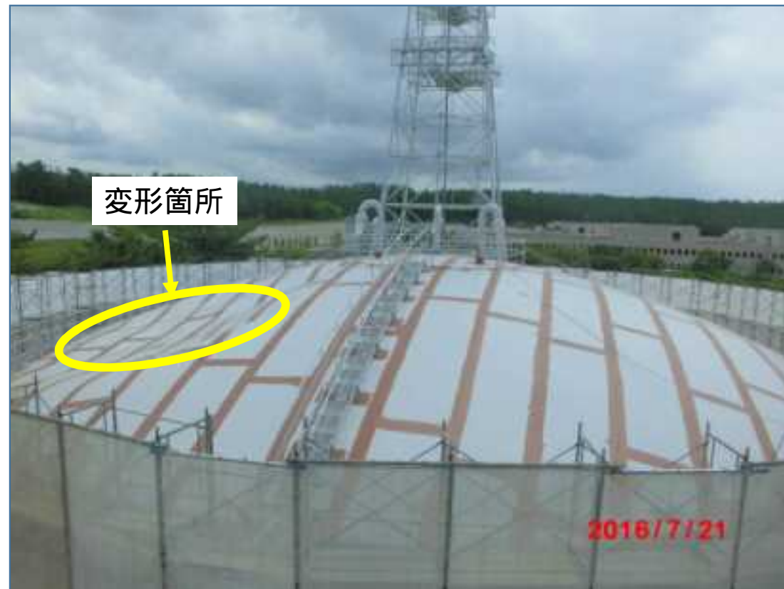
ろ過水タンク変形箇所
