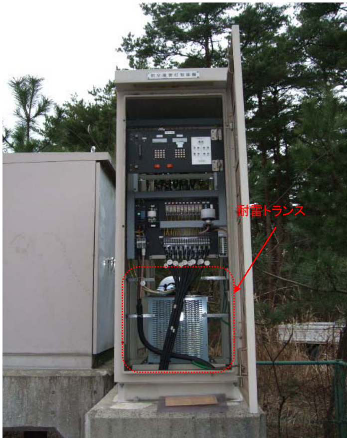
航空障害灯制御盤内
