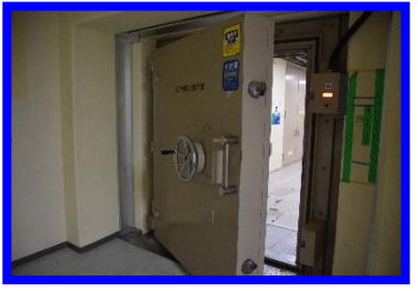
水密扉等の溢水対策 (屋内複数箇所)
