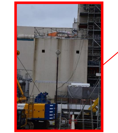
フィルタバント設備 (地上式)
