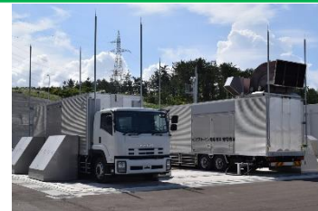
空冷式ガスタービン発電機車 (建屋脇及び高台待機)
