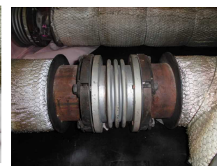
No.7排気管継手（外面） (R側)
