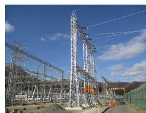
新福島変電所
