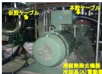
4号機 残留熱除去機器冷却系ポンプ(A) 本設ケーブルへの切替後
