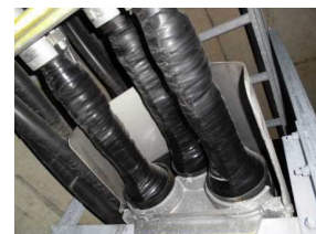
<66kV遮断器～低起動変圧器6SB間の接続部>
