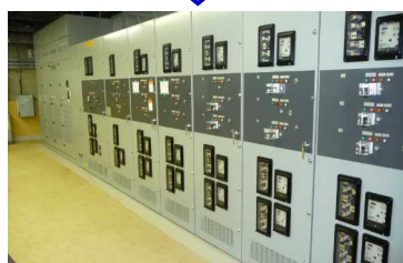
1号機 電源盤(P/C 1C-1)据付後
