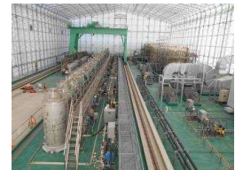
(高性能多核種除去設備)
