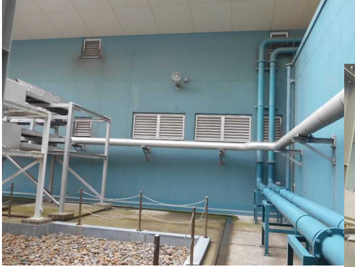
6号機コントロール建屋 中央制御室再循環送風機室
