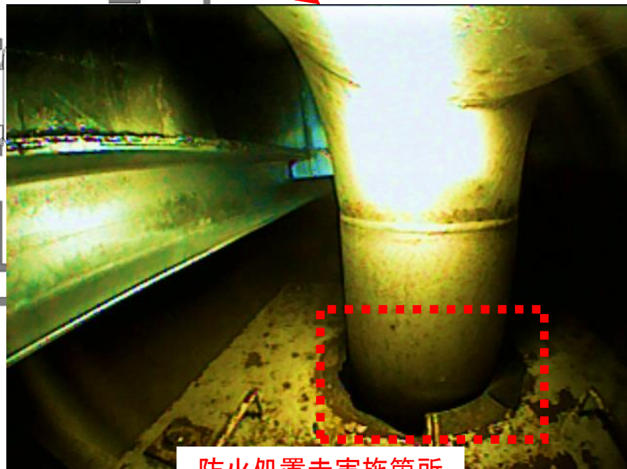
防火処置未実施箇所
