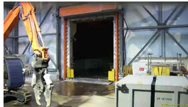
2号機 原子炉建屋西側開口部
