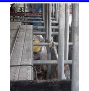
(凍結管バルブ開閉操作の様子)
