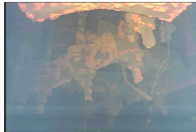
3号機 原子炉格納容器底部の調査（7月19日） [制御棒駆動機構の支持構造物]
