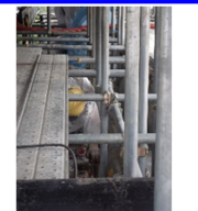
(凍結管バルブ開閉操作の様子)
