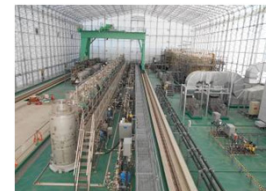
(高性能多核種除去設備)
