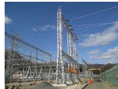
新福島変電所
