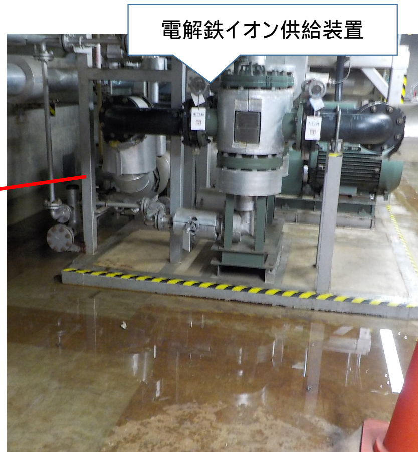
電解鉄イオン供給装置の周辺の海水漏えい状況
