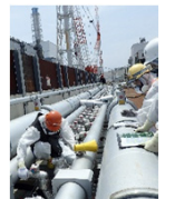
(凍結管バルブ開閉操作の様子)
