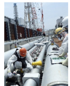
(凍結管バルブ開閉操作の様子)
