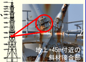
＜破断箇所の状況＞
