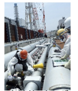
(凍結管バルブ開閉操作の様子)
