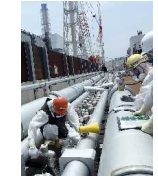
(凍結管バルブ開閉操作の様子)
