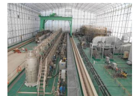
(高性能多核種除去設備)
