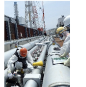
(凍結管バルブ開閉操作の様子)
