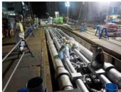
冷媒の移送管
