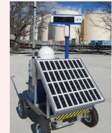
線量率モニタの設置状況
