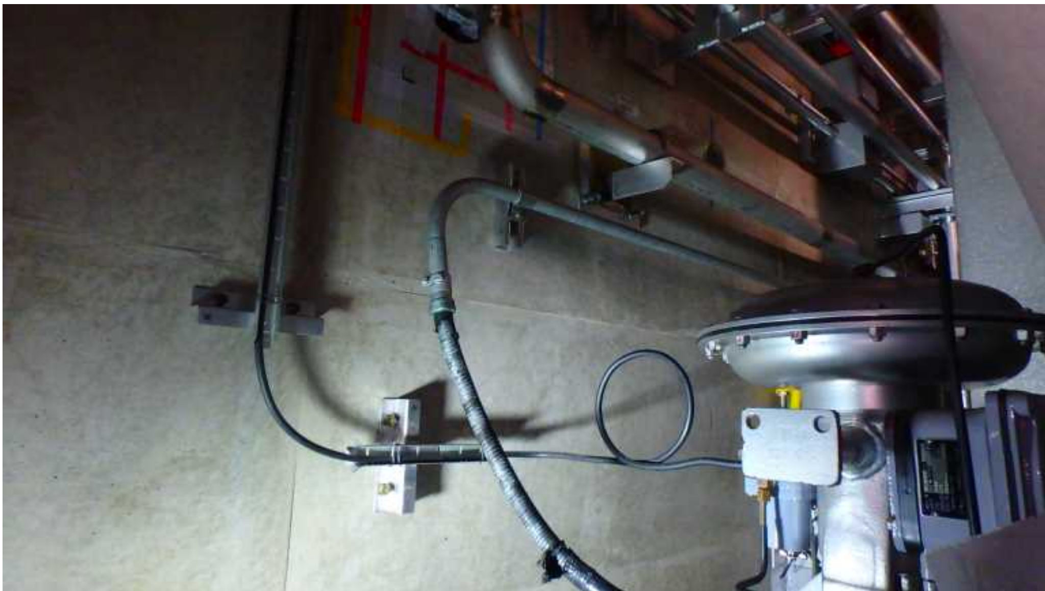
発煙が確認された電線管
