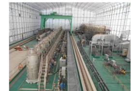
(高性能多核種除去設備)
