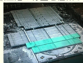
<遮へい体の設置状況>
