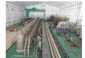
(高性能多核種除去設備)
