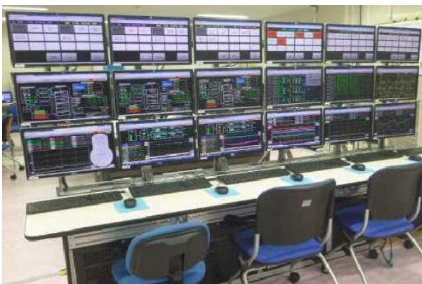
集中監視システム設置状況 (2015年2月)
