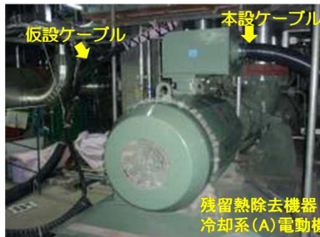
4号機 残留熱除去機器冷却系ポンプ (A) 本設ケーブルへの切替後
