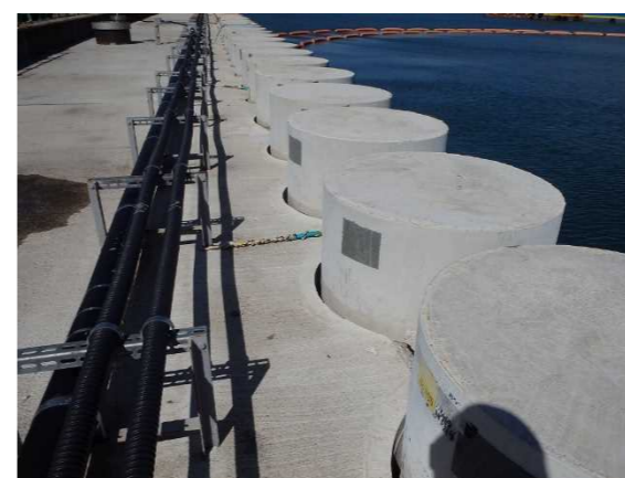
鋼管矢板際の状況（補修実施前） （右写真の補修実施後の場所とは異なる）
