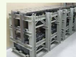
直流125V蓄電池等を追設し、従前の3倍以上（24時間以上）の直流電源容量を確保
