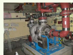
高圧代替注水設備を追設し原子炉注水機能を多重化
