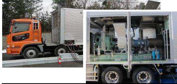
ガスタービン発電機車 (高台配備)
