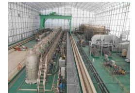
(高性能多核種除去設備)
