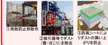
① 飛散防止剤散布 ② 吸引器等でダスト（塵・ほこり）を除去 ③ 防風シートによりダストの舞上りを防止 ④ モニターを追加設置してダスト監視体制を強化 放出抑制への取り組み
