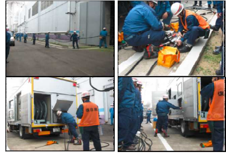
ガスタービン発電機起動訓練の様子
