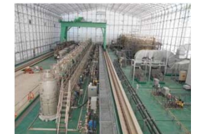
(高性能多核種除去設備)
