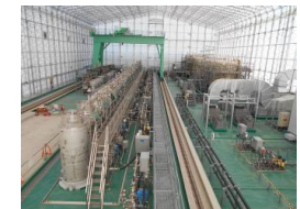
(高性能多核種除去設備の設置状況)
