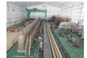
(高性能多核種除去設備の設置状況)
