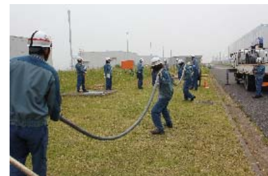
✓ 仮設ケーブル接続訓練
