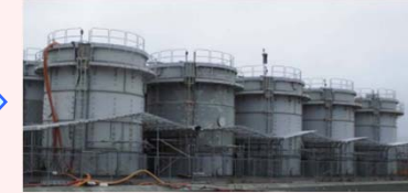
堰カバー設置後
