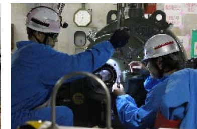
✓ 冷却水ポンプ復旧訓練
