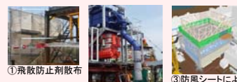
①飛散防止剤散布 ②吸引器等でダストリダストの舞上り(塵・ほこり)を除去 ③防風シートによるダストの舞上り防止
