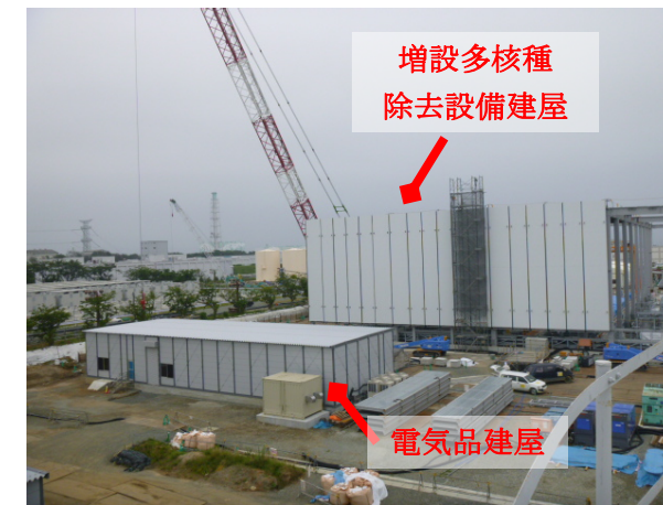
図3：増設多核種除去設備 全景
