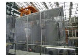
(放射性物質を吸着する設備の設置状況)
