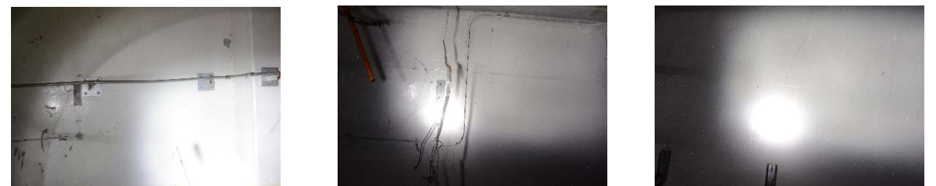
図3：1号機 機器ハッチに面する西側壁面(中央部)（左から順に4階、3階、2階）
