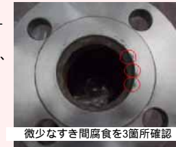
微小なすき間腐食を3箇所確認 供給ポンプ1 出口配管フランジ C系統腐食対策有効性確認状況
