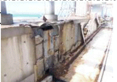
例：磚子室外部劣化腐食
