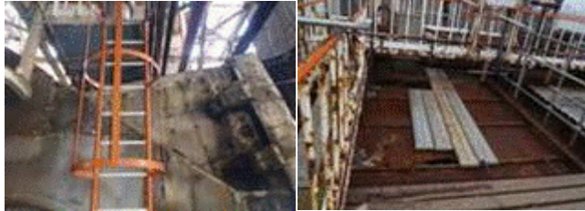
例：煙風道ケーシングガス漏れ・腐食穴あき
