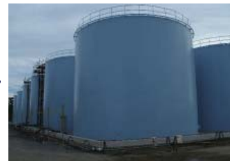
溶接型タンク
