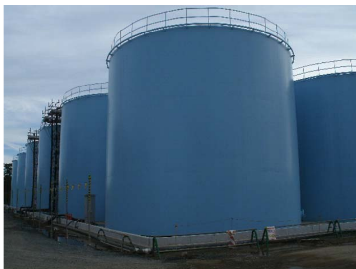
鋼製円筒型タンク（溶接型）
