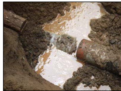
埋設消火配管の損傷
